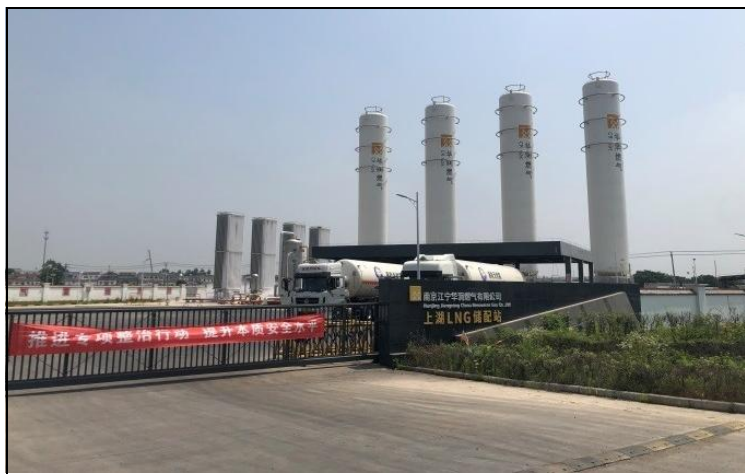
图 3-98 LNG 燃气储备站
