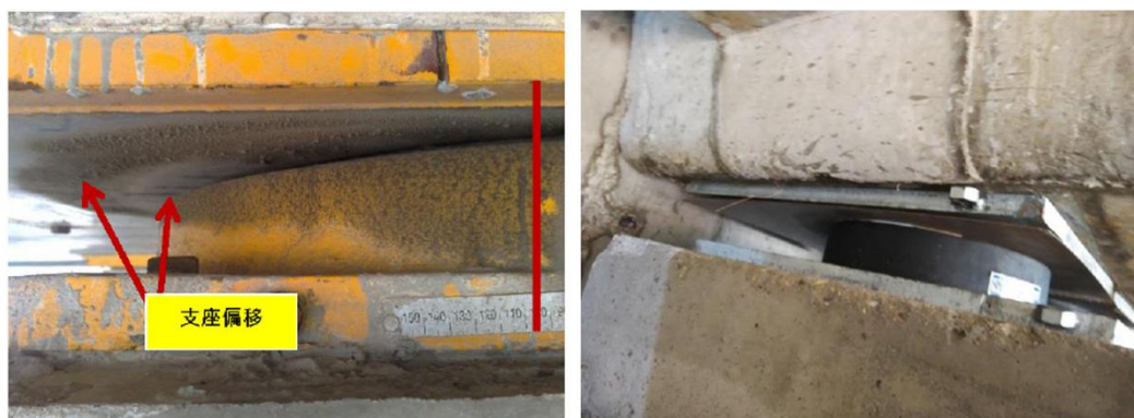
施工控制不当引起的桥桩偏移
